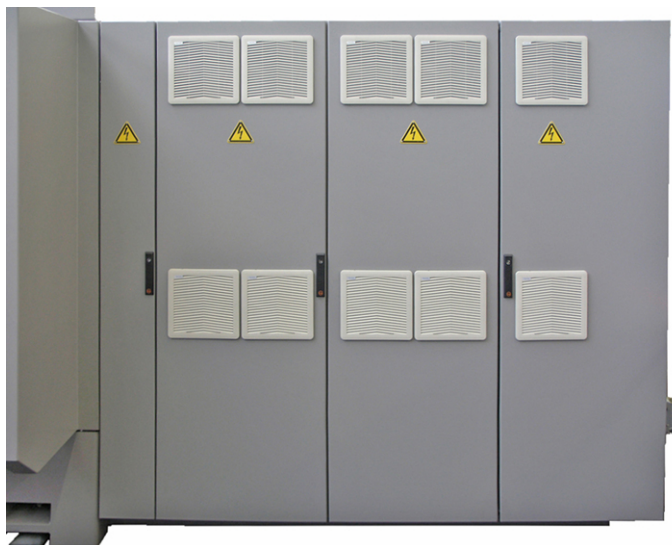
Beispiel: Filter am Schaltschrank
